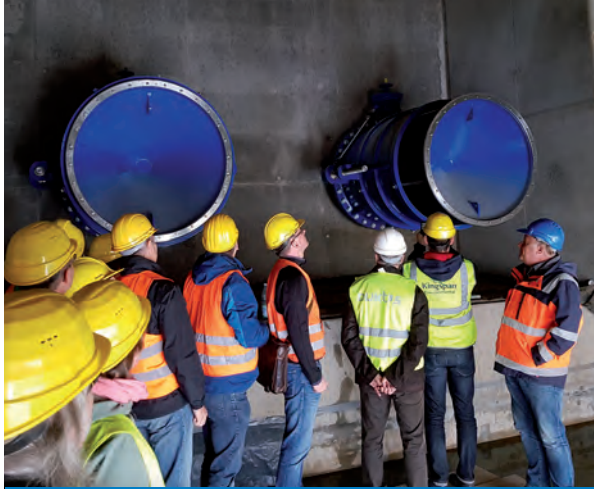
Besichtigung der Toskammer und des Kegelstrahlschiebers des Hochwasserrückhaltebeckens Niederpöbel (Foto: Ulf Möricke)
