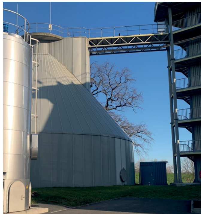
Kläranlage Dessau, Faulung und Cosubstratspeicher
