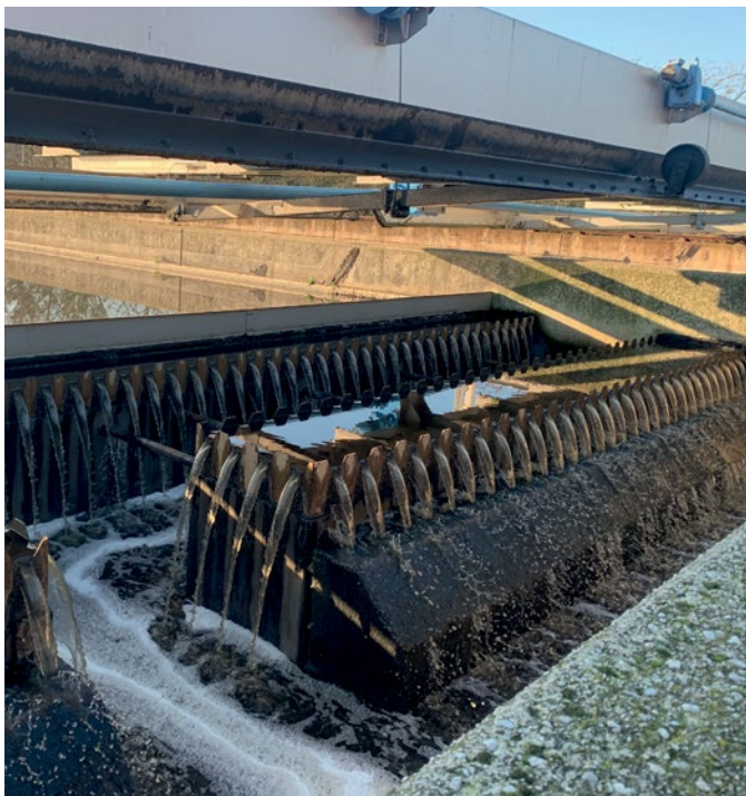
Kläranlage Dessau, Ablauf Vorklärung
